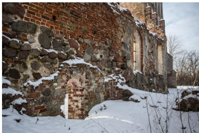
Рисунок 5 – Современное состояние здания (фрагменты повреждений) [1]
