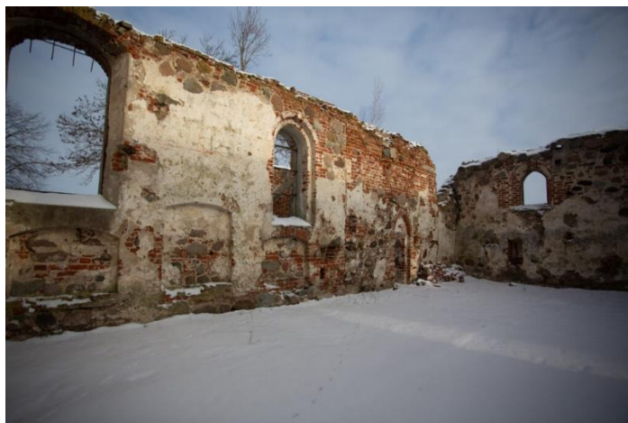
Рисунок 3 – Современное состояние здания (фрагменты повреждений) [1]
