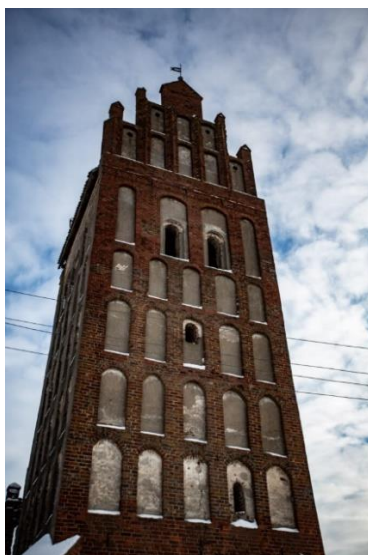
Рисунок 4 – Современное состояние здания (фрагменты повреждений) [1]
